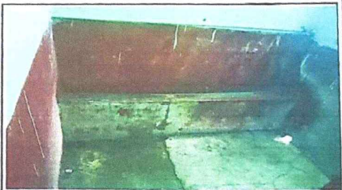
Foto 4: Sustrucción de mingitorio (1)
